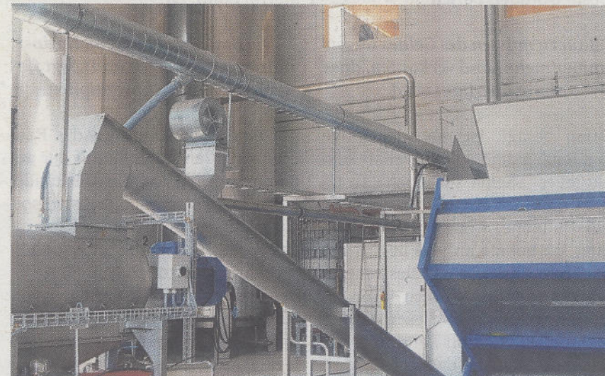
Die neue Hygienisierungsanlage, die am 1. Juli in Betrieb genommen wurde.
